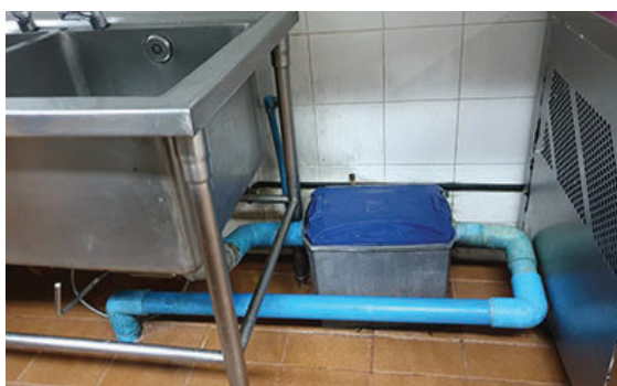
ติดตั้งระบบบำบัดน้ำเสียขั้นต้น ได้แก่ ถังดักไขมัน บริเวณใต้อ่างล้างจาน และมีการดักไขมันออกอย่าง สม่ำเสมอ
