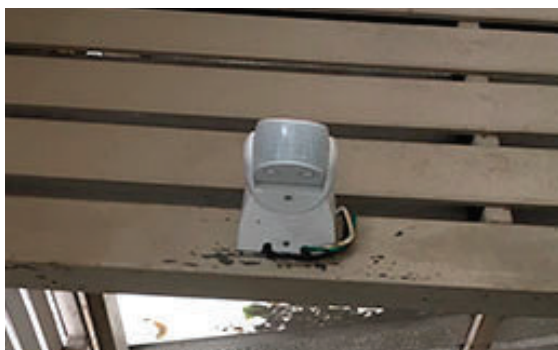
ติดตั้งเครื่องใช้ไฟฟ้าแบบเปิดปิดอัตโนมัติบริเวณทางเข้าห้องน้ำ เพื่อประหยัดพลังงาน
